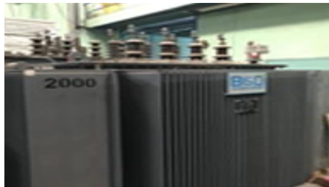
Gambar 4. Trafo yang tersedia di Power Shore Connection TPM
