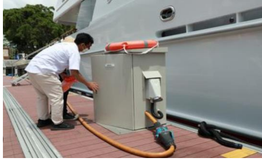
Gambar 5. Terminal Listrik Pelabuhan untuk listrik kapal
